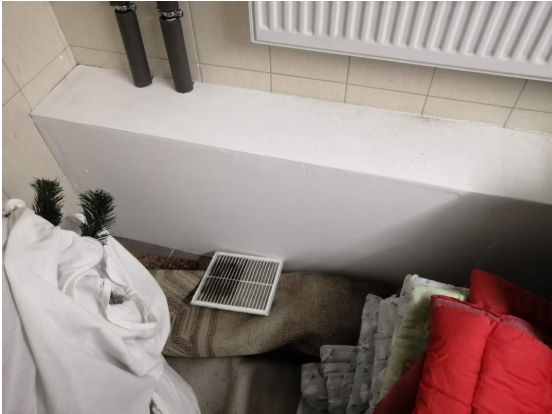
рис. 17. Выпавшая решетка системы перетока, кладовая (п.33, подвал)
