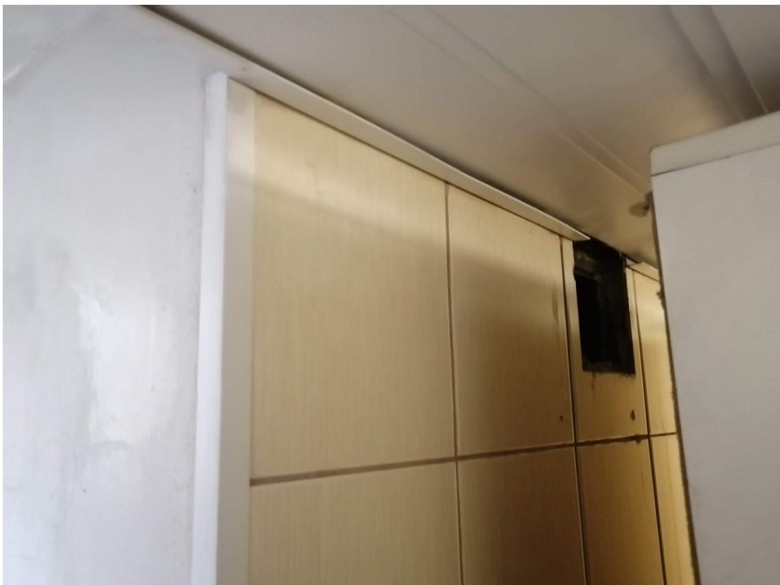
рис. 18. Отверстие без решетки системы перетока, кладовая делья (п.34, подвал)
