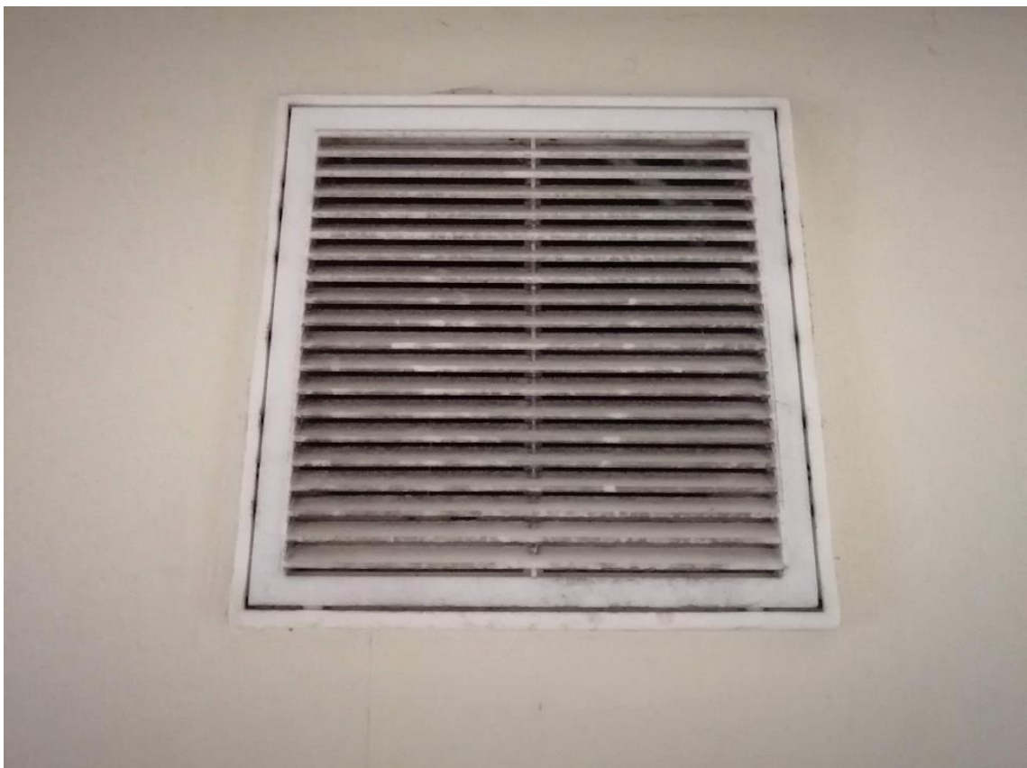
рис. 13. Загрязненная решетка на вентканале, коридор (п.21, 2-й этаж)
