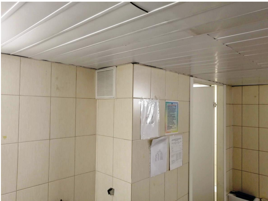
рис. 11. Решетка на вентканале, прачечная (п.30, подвал)
