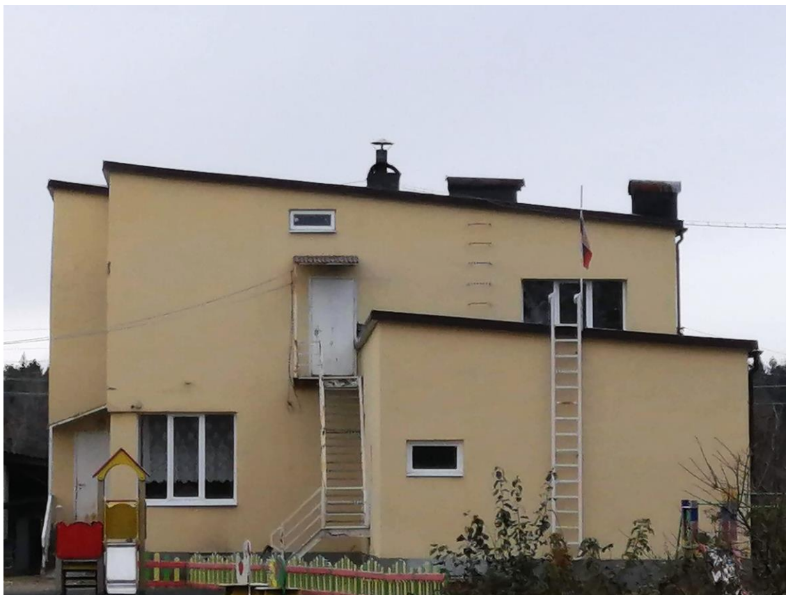
рис. 7. Вентканалы на кровле
