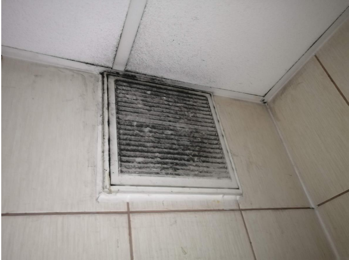
рис. 12. Загрязненная решетка на вентканале, душевая (п.4, 1-й этаж)
