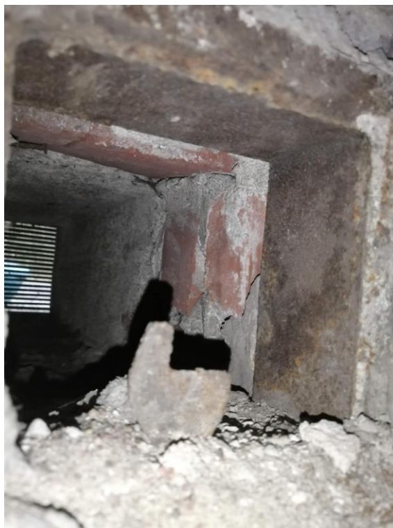
рис. 19. Отверстие без решетки системы перетока, кладовая делья (п.34, подвал)
