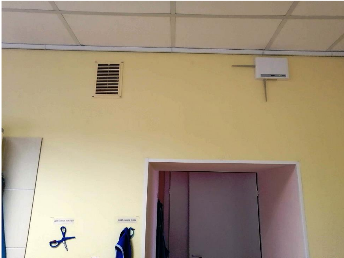
рис. 19. Типичная решетка на вентканале в помещениях
