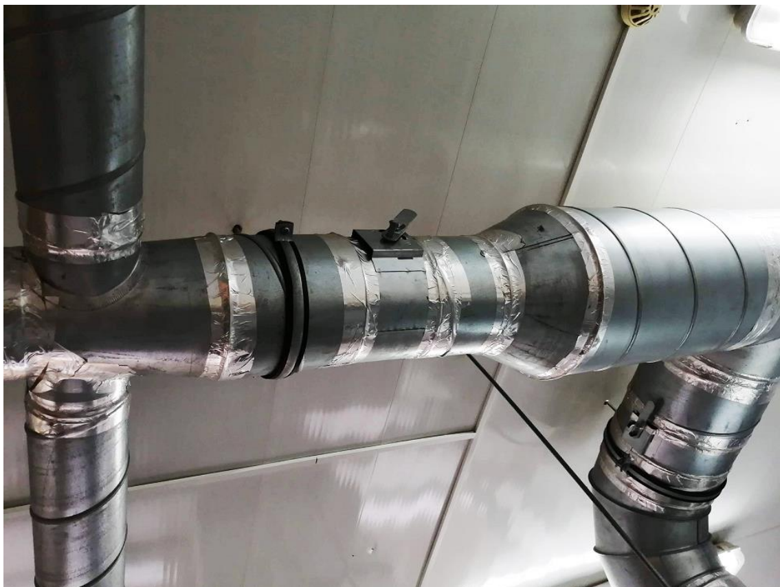
рис. 4. Воздуховоды и элементы системы В1, кухня (п.16, 1-й этаж)
