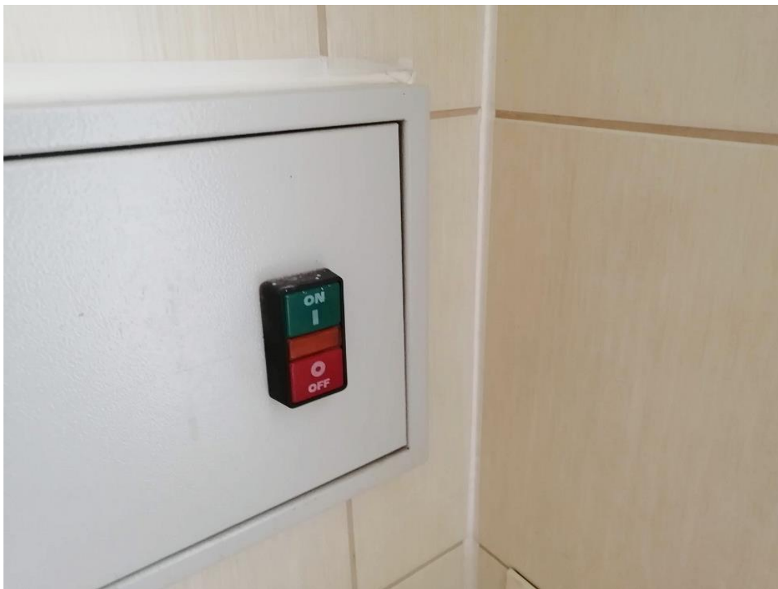
рис. 12. Пусковая кнопка системы вентиляции В2, гладильная (п.19, 1-й этаж)
