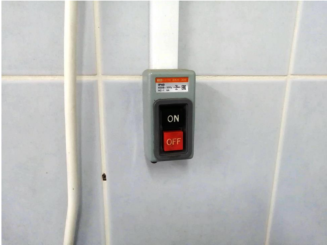
рис. 3. Пусковая кнопка системы В1, кухня (п.16, 1-й этаж)
