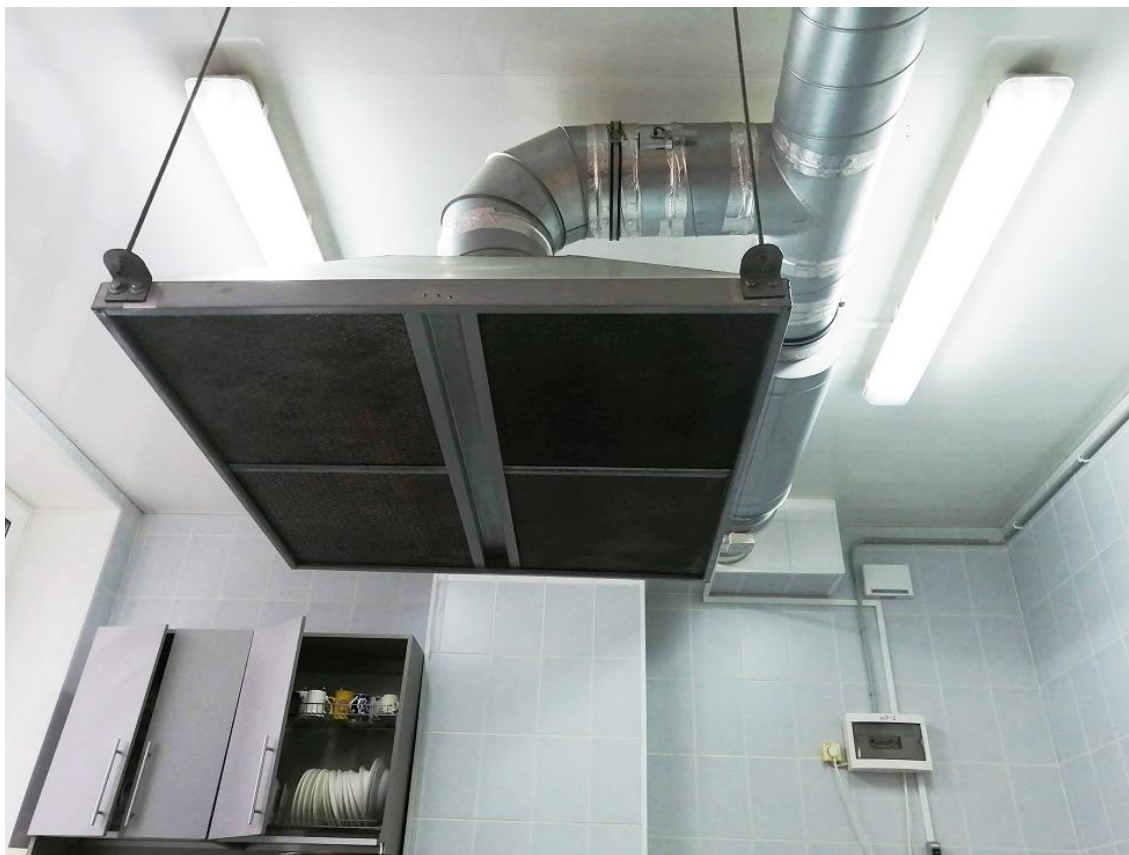
рис. 5. Зонт вытяжной системы В1 над одной эл/плитой, кухня (п.16, 1-й этаж)
