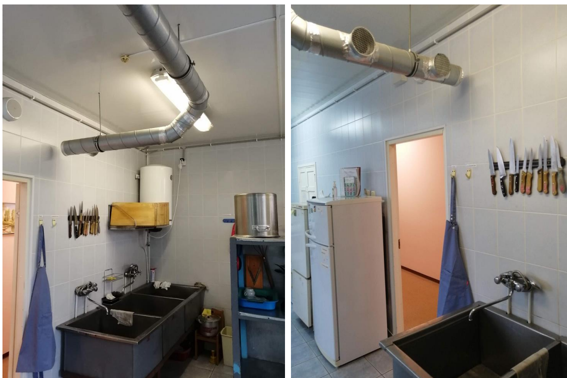
рис. 8. Моечные ванны не оборудованы вытяжными зонтами, кухня (п.16, 1-й этаж)
