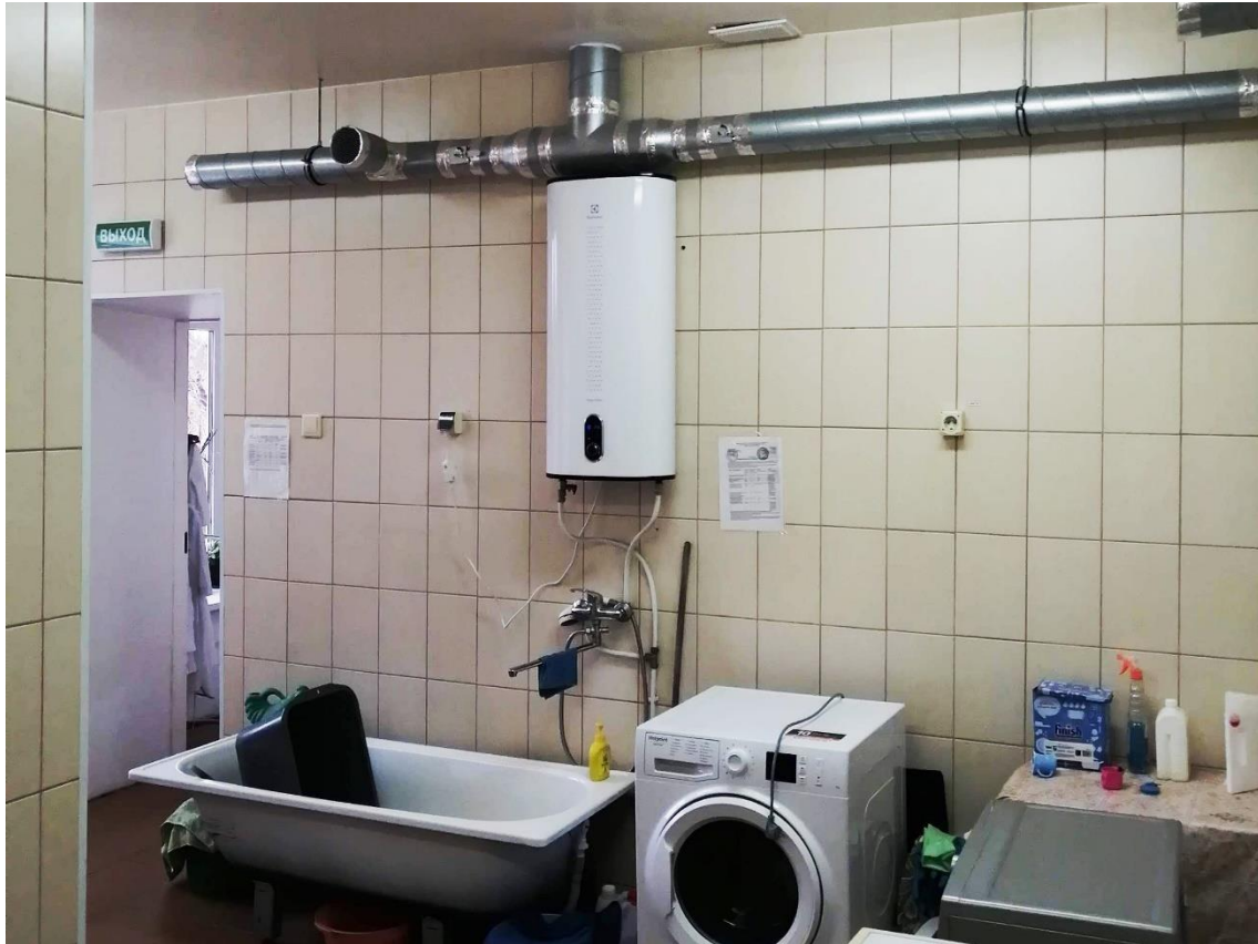
рис. 10. Вытяжная система вентиляции В2, постирочная (п.20, 1-й этаж)
