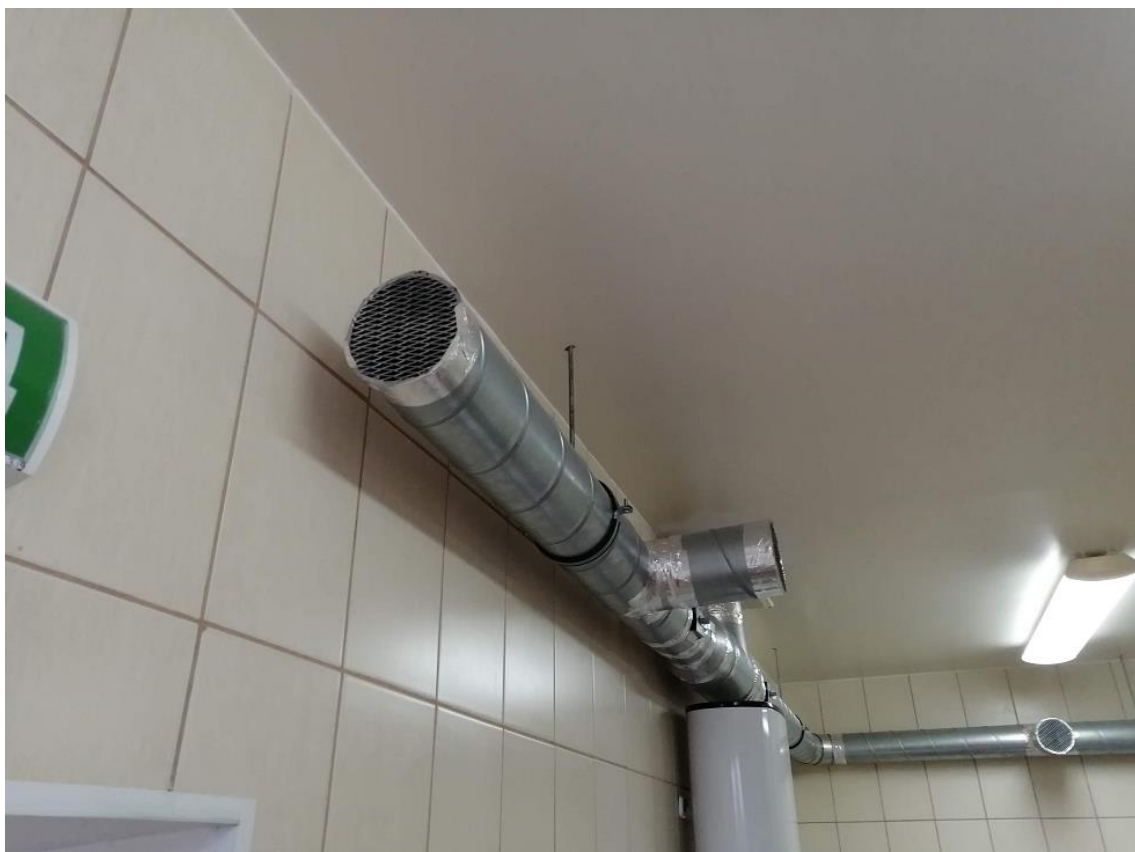
рис. 11. Вытяжная система вентиляции В2, постирочная (п.20, 1-й этаж)
