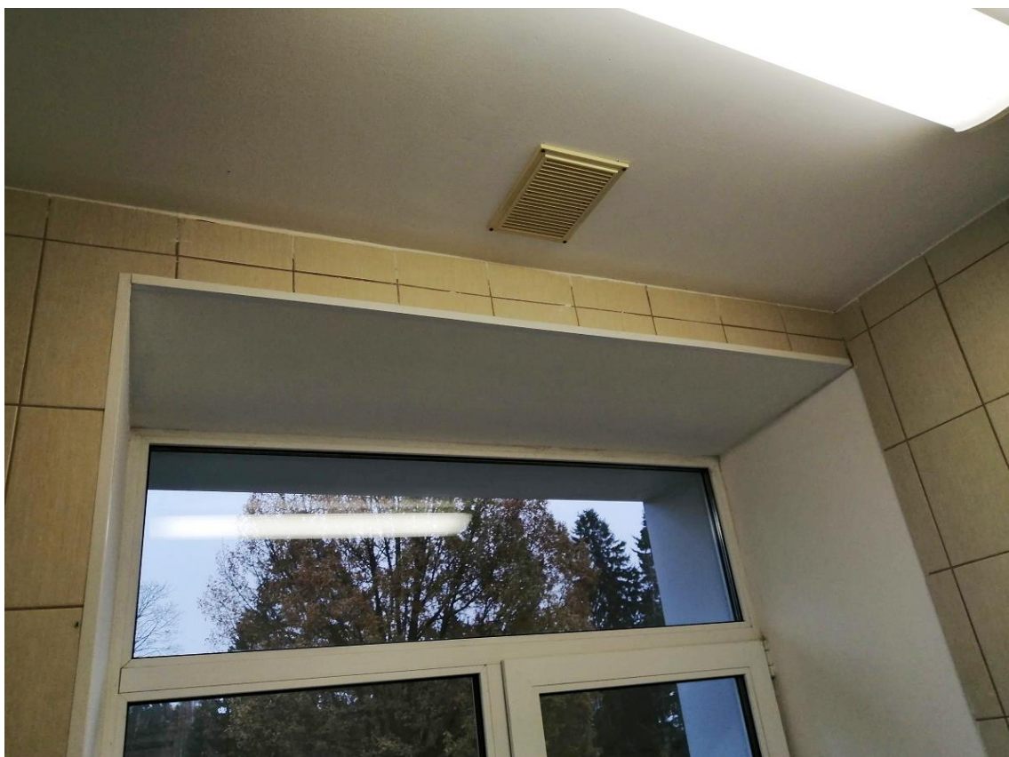
рис. 20. Типичная решетка на вентканале в помещениях
