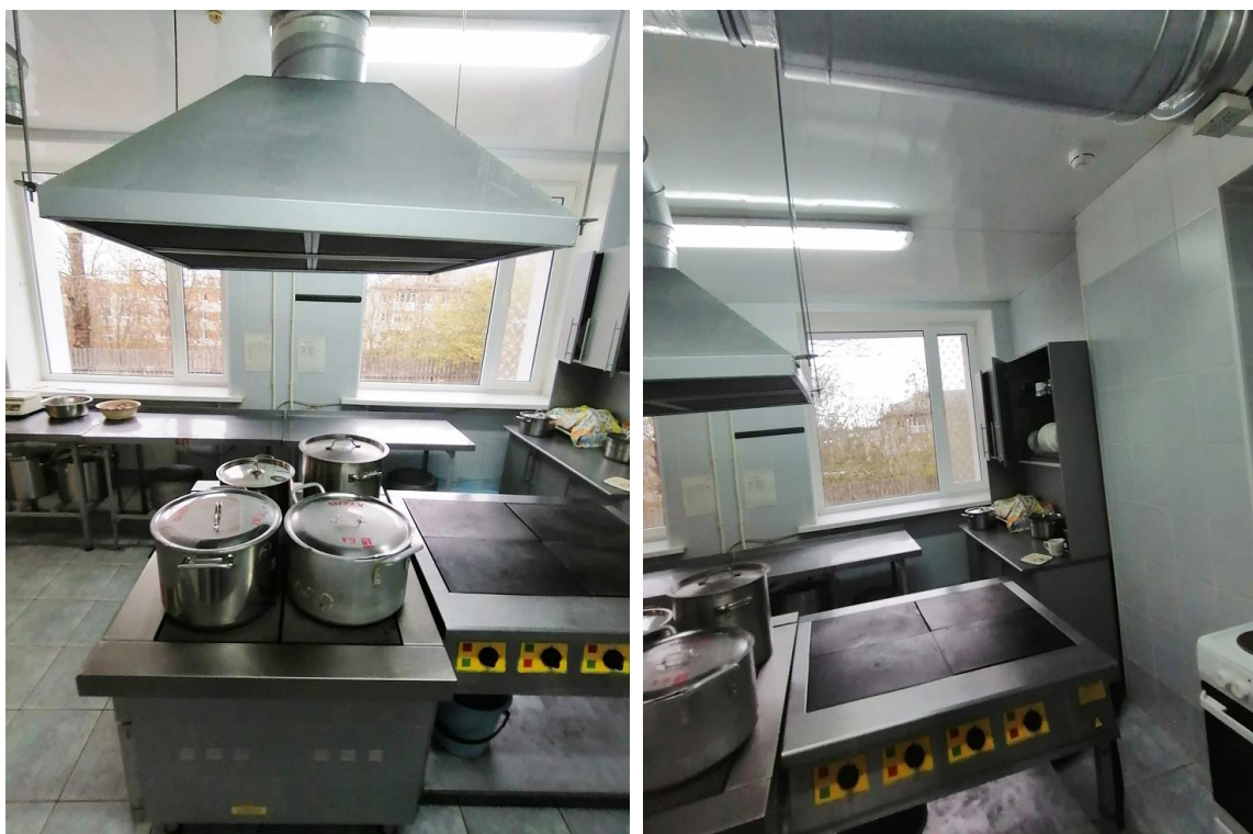
рис. 6. Зонт установлен только над одной эл/плитой, вторая эл/плита не оборудована вытяжным зонтом, кухня (п.16, 1-й этаж)
