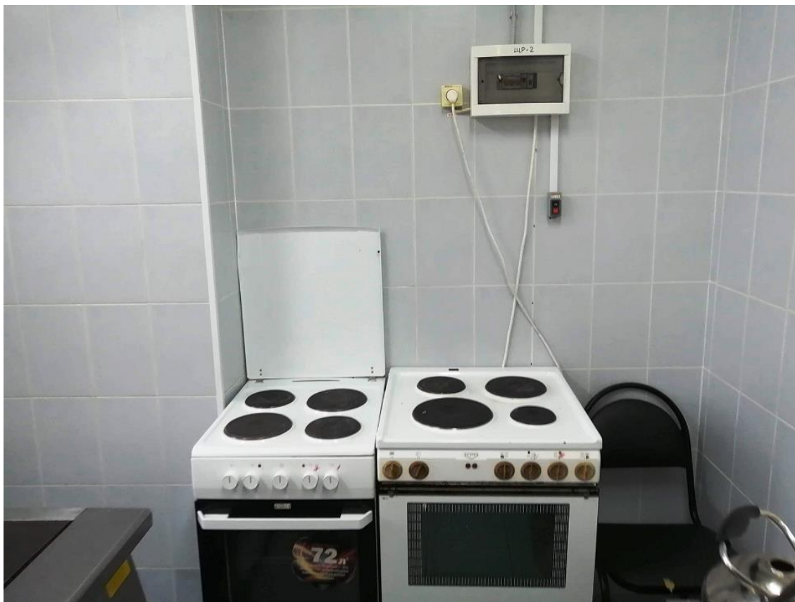
рис. 7. Эл/плиты не оборудованы вытяжными зонтами, кухня (п.16, 1-й этаж)
