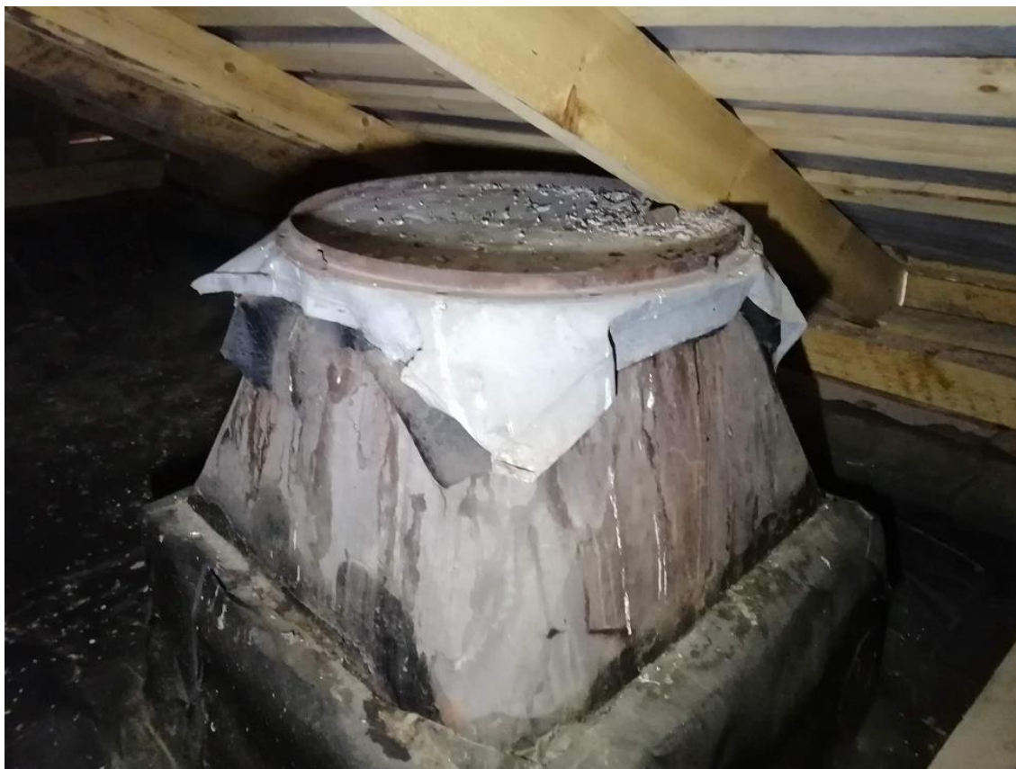
рис. 56. Заглушенная вентиляционная шахта №1 над спортивным залом, чердак
