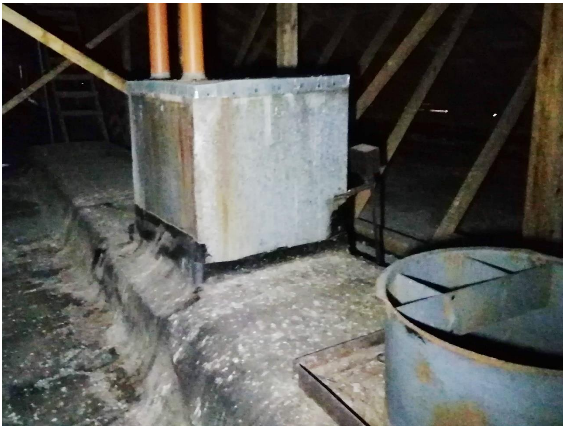
рис. 42. Вентканалы на чердаке с вентшахтой №2, чердак над 3-м этажом
