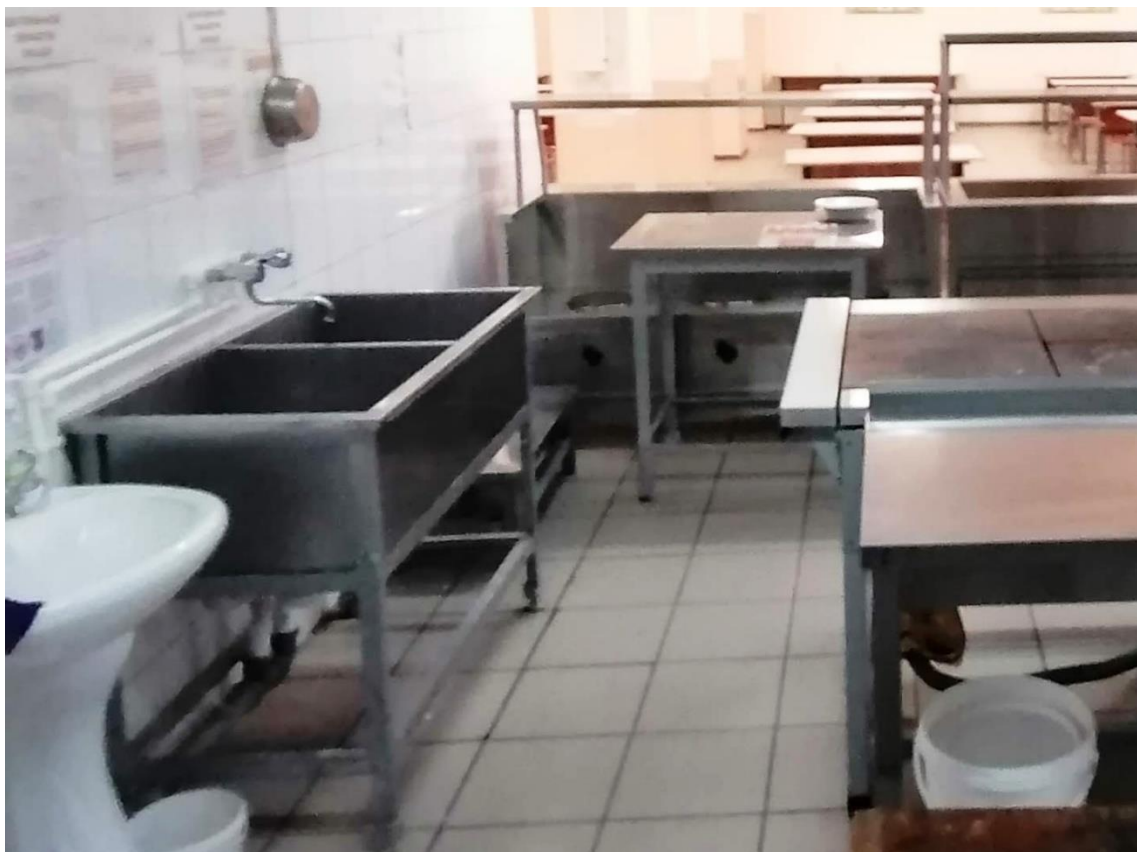
рис. 16. Моечные ванны не оборудованы вытяжными зонтами, горячий цех (п.33, 2-й этаж)
