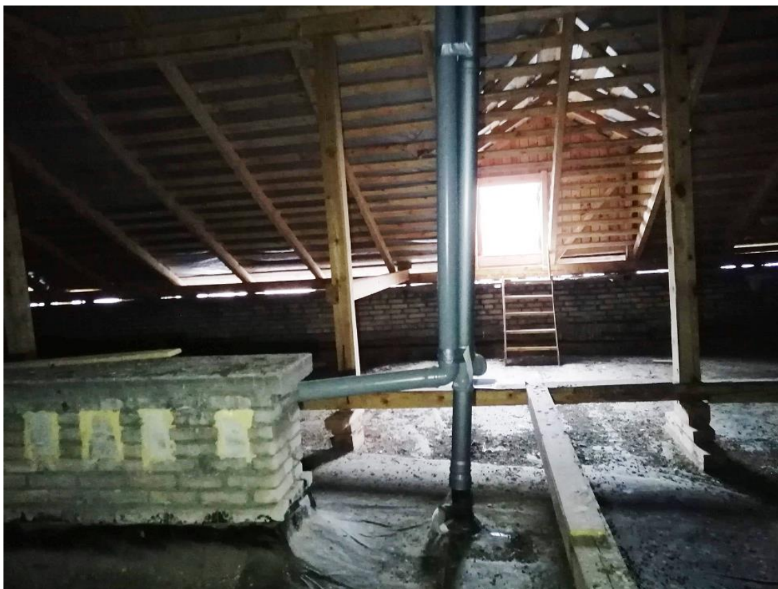
рис. 51. Заблокированные вентшахты, чердак над 2-м этажом
