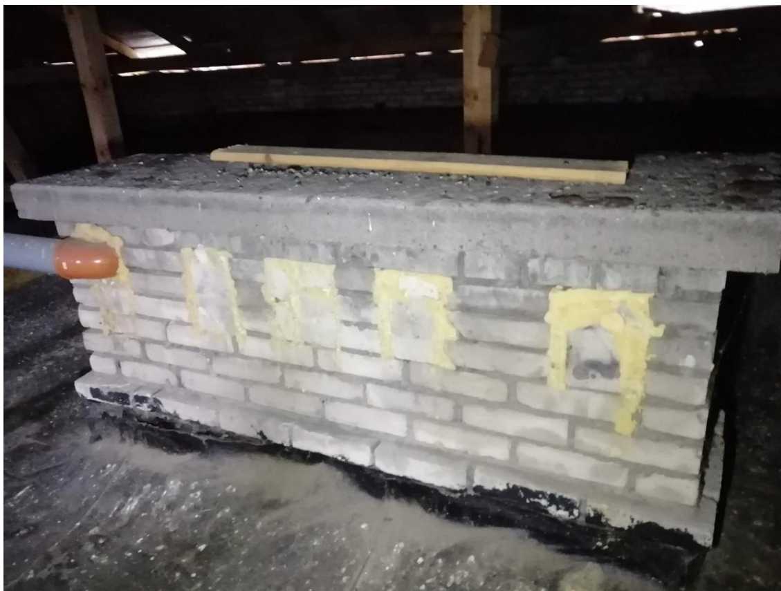
рис. 52. Заблокированные вентиляционные шахты, чердак над 2-м этажом
