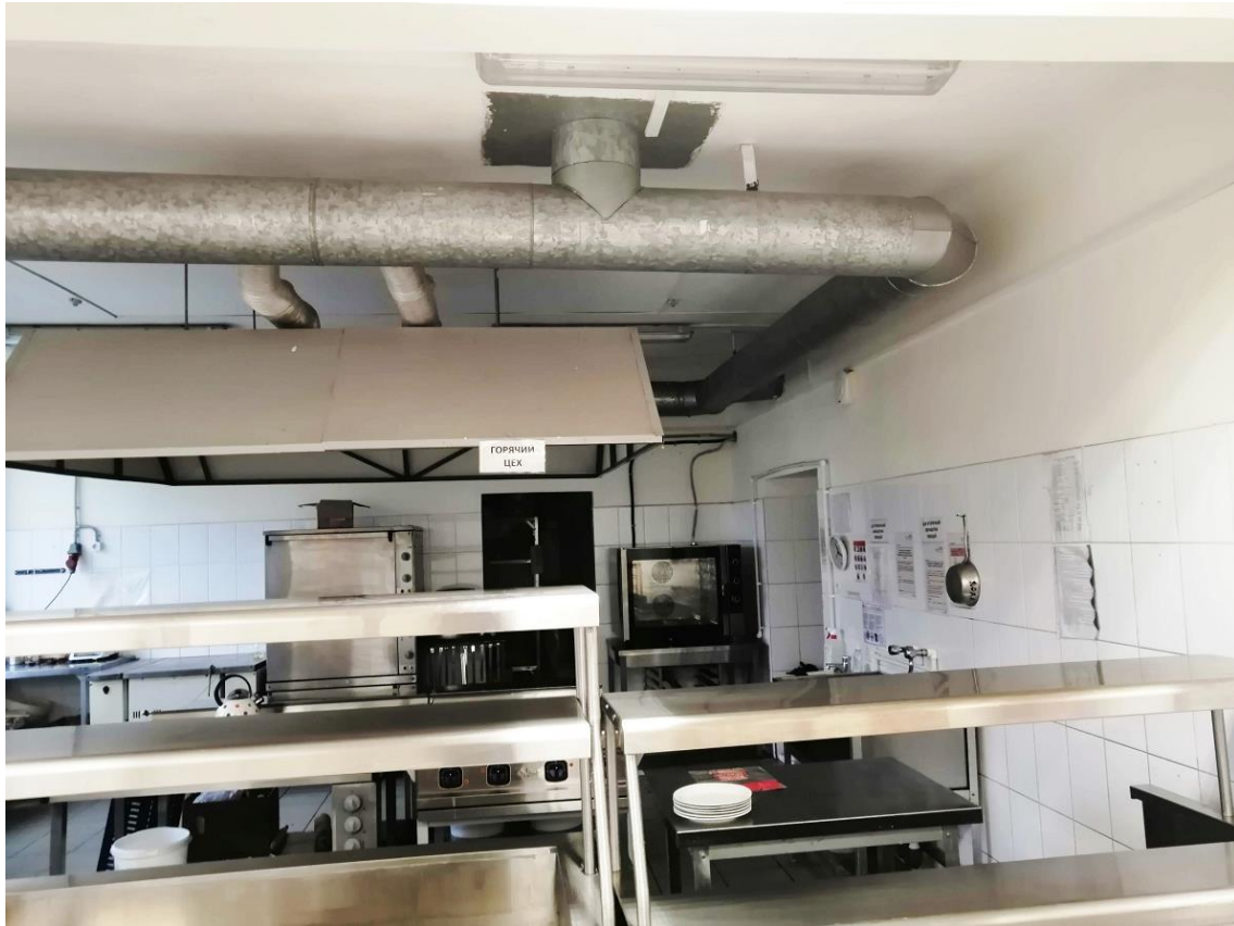
рис. 6. Нерабочая вытяжная вентиляция, горячий цех (п.33, 2-й этаж)
