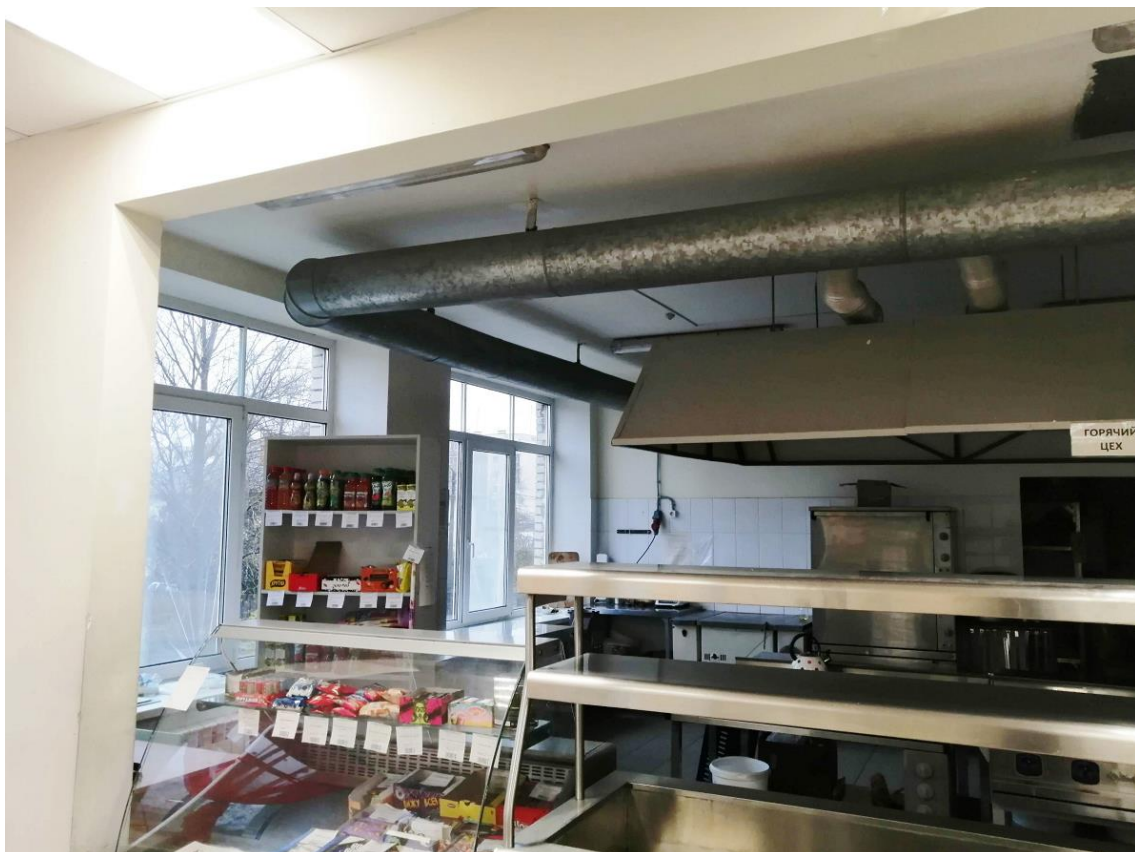
рис. 7. Нерабочая вытяжная вентиляция, горячий цех (п.33, 2-й этаж)
