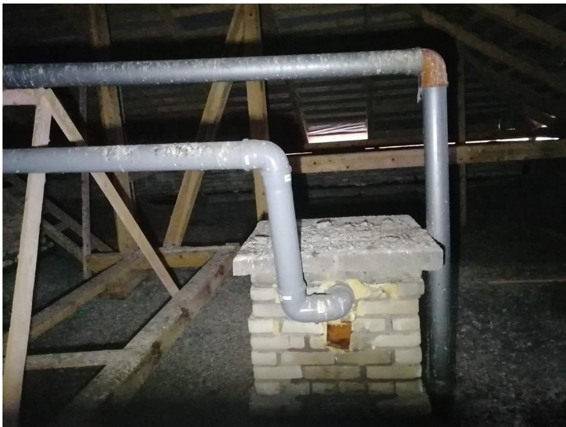
рис. 54. Заблокированные вентиляционные шахты, чердак над 2-м этажом
