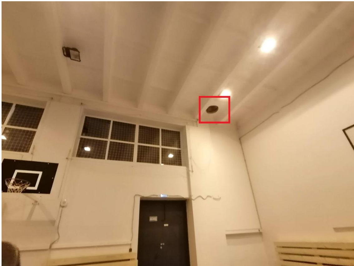
рис. 22. Закрытая шахта дымшей естественной вытяжной вентиляции, спортивный зал (п.31, 1-й этаж)
