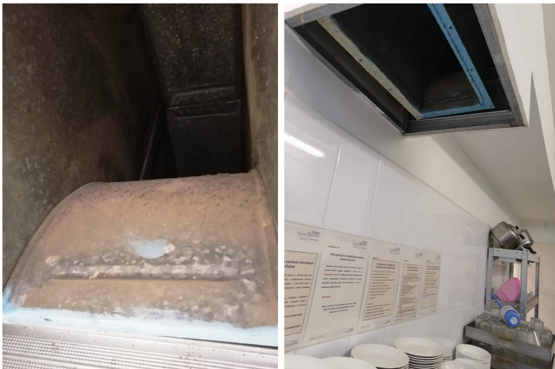
рис. 14. Фрагмент воздуховода бывшей приточной вентиляции, моечная (п.38, 2-й этаж)
