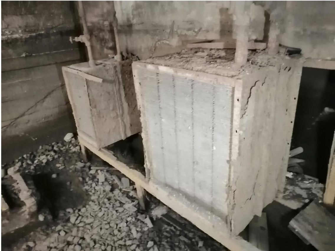
рис. 2. Секции воздухонагревателей бывших систем приточной вентиляции, венткамера (подвал)
