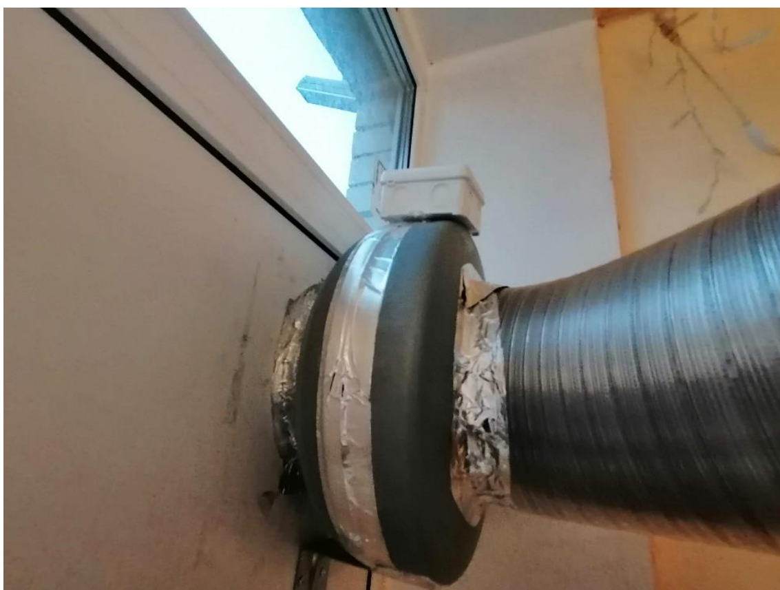
рис. 31. Вентилятор вытяжной системы В2, кабинет химии (п.29, 2-й этаж)
