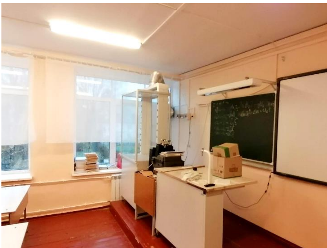
рис. 29. Лабораторный шкаф, система вытяжной вентиляции В2, кабинет химии (п.29, 2-й этаж)
