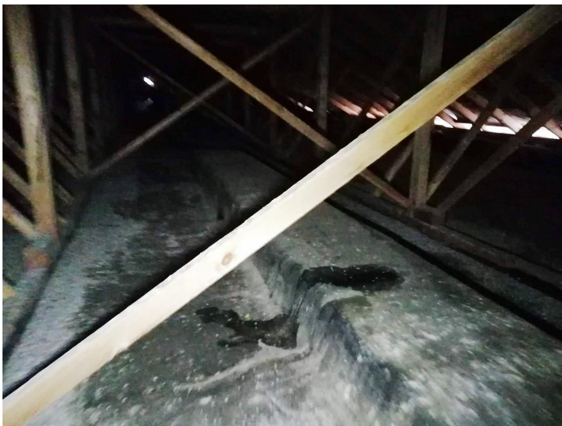
рис. 47. Вентканалы, чердак над 3-м этажом
