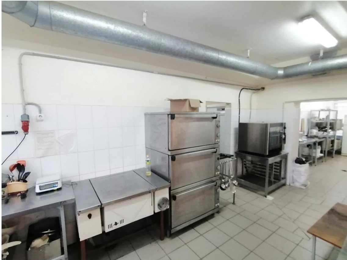
рис. 15. Пароконвектомат, жарочный шкаф и эл/сковорода не оборудованы вытяжными зонтами, горячий цех (п.33, 2-й этаж)
