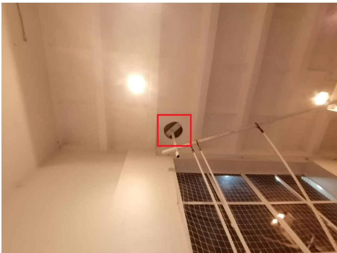
рис. 23. Закрытая шахта дымшей естественной вытяжной вентиляции, спортивный зал (п.31, 1-й этаж)
