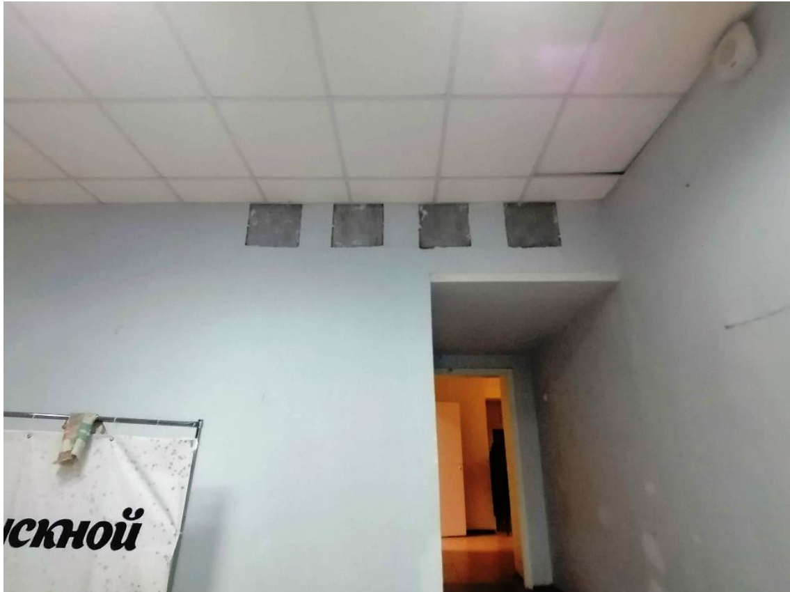
рис. 19. Решетки, вероятно, бывшей приточной вентиляции, актовый зал (п.27, 1-й этаж)
