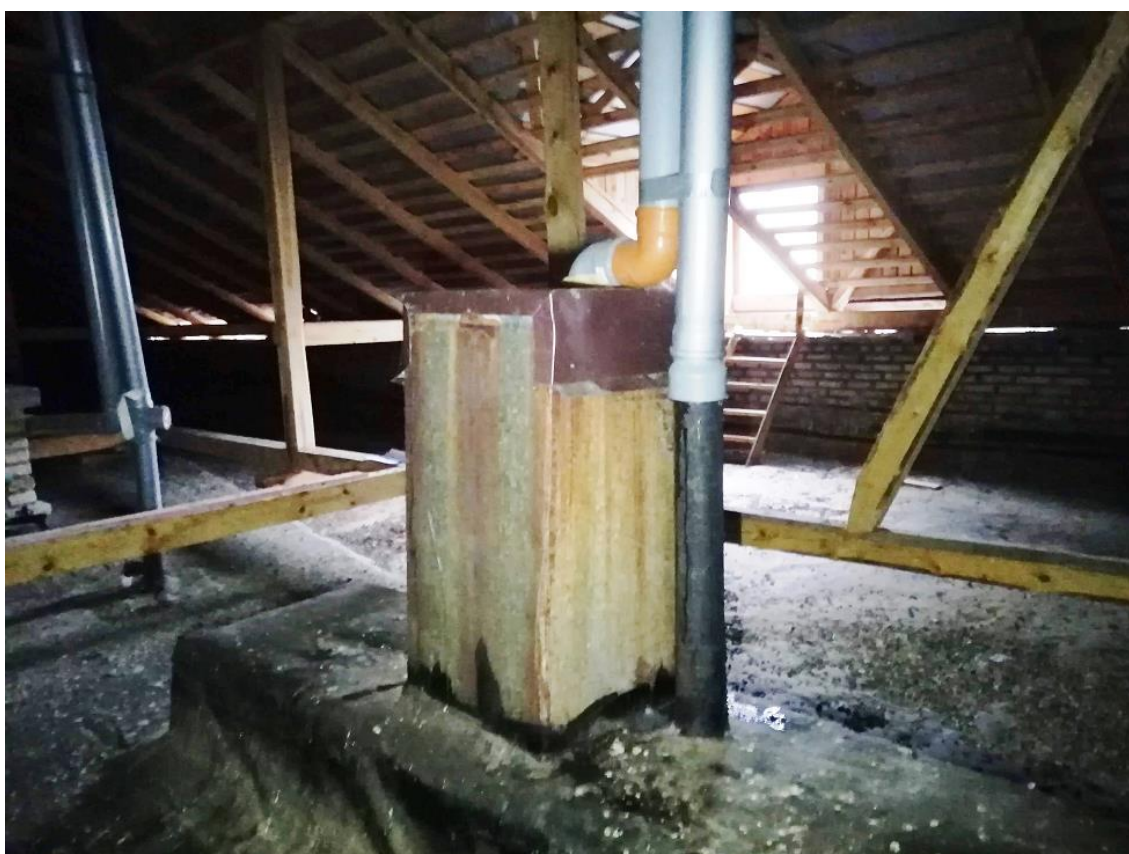
рис. 55. Вентканалы на чердаке с вентиляционной шахтой, чердак над 2-м этажом над раздевалками при спортивном зале
