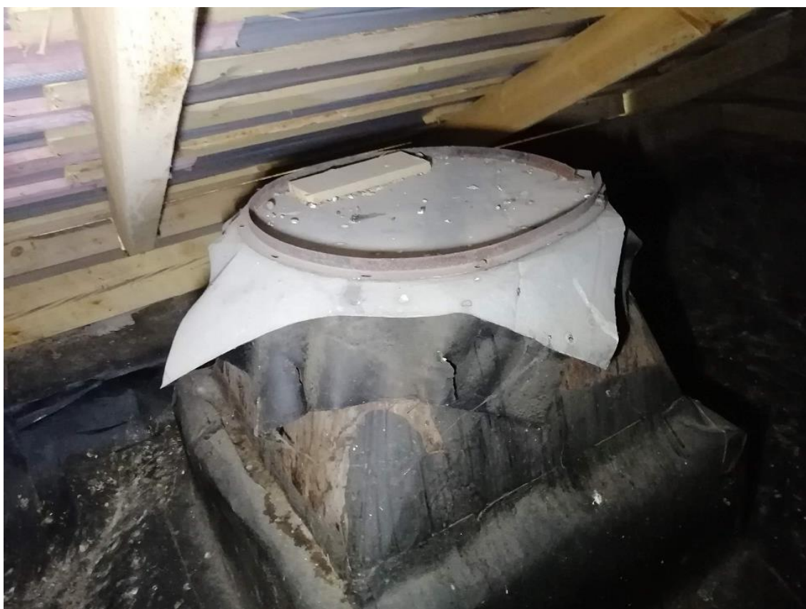
рис. 57. Заглушенная вентиляционная шахта №2 над спортивным залом, чердак
