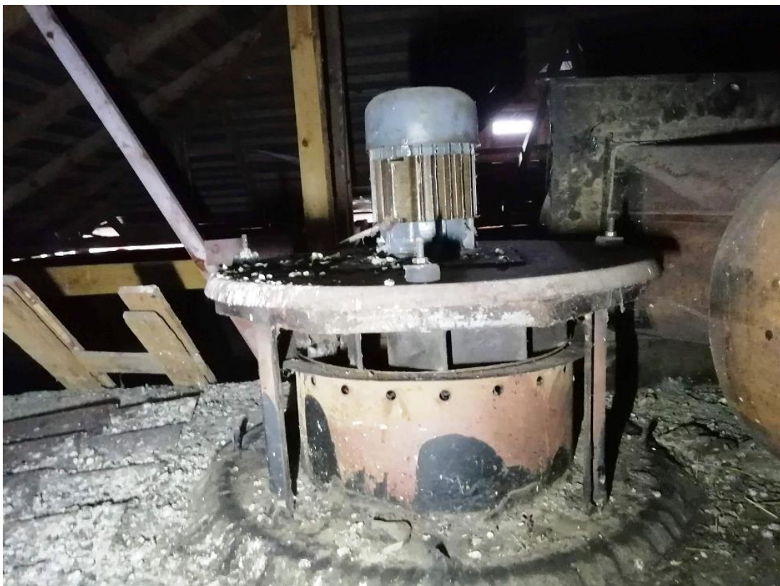
рис. 11. Нерабочий вентилятор системы вытяжной вентиляции горячего цеха и моечной, чердак
