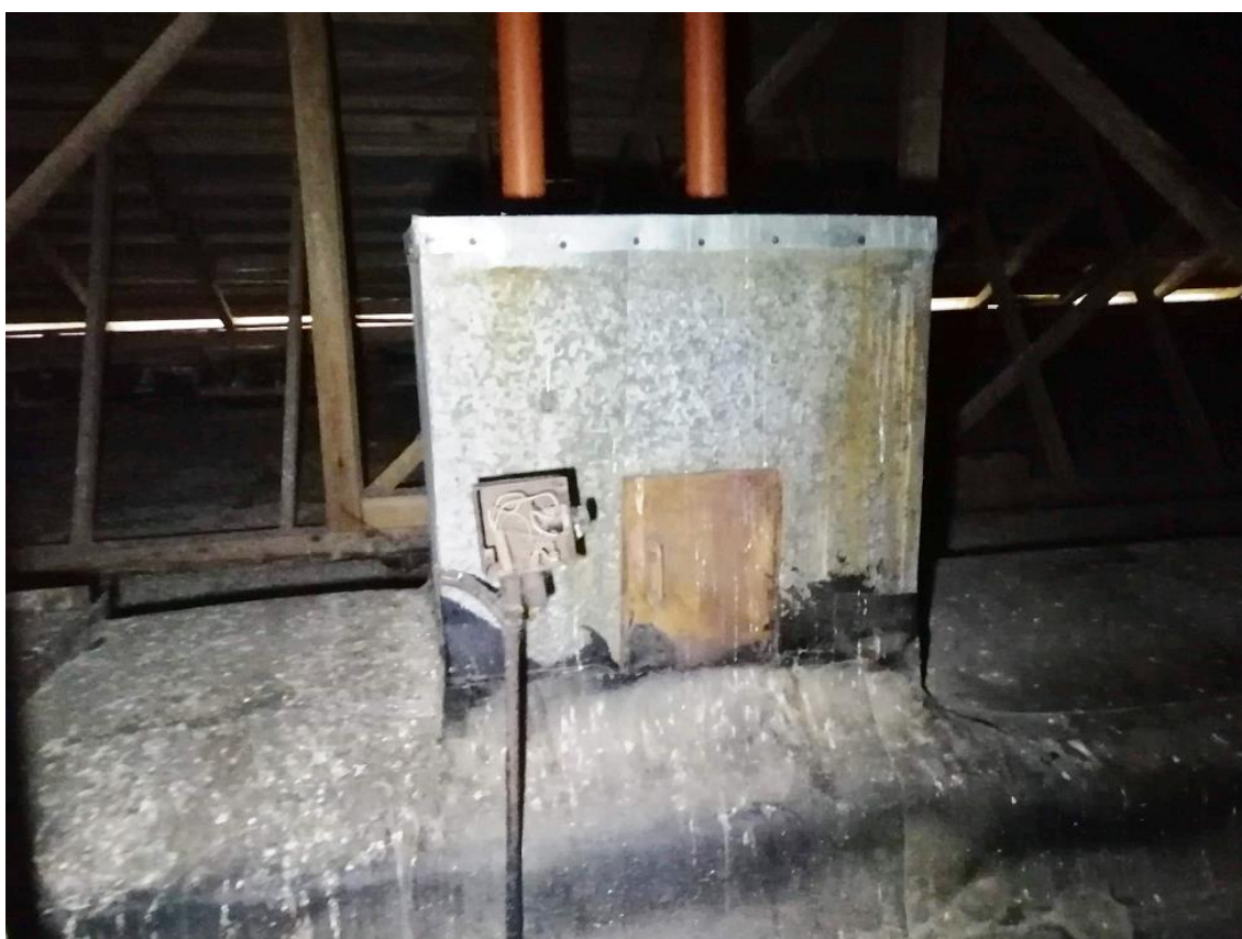
рис. 43. Клеммная коробка на вентшахте №2, чердак над 3-м этажом
