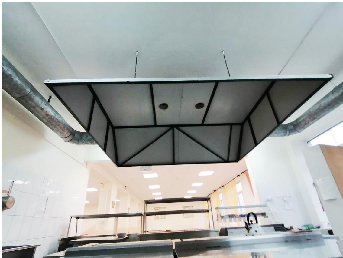
рис. 9. Зонт нерабочей вытяжной вентиляции, горячий цех (п.33, 2-й этаж)
