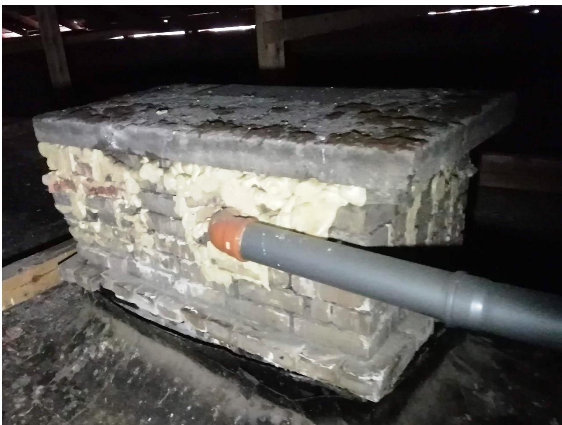
рис. 53. Заблокированные вентиляционные шахты, чердак над 2-м этажом
