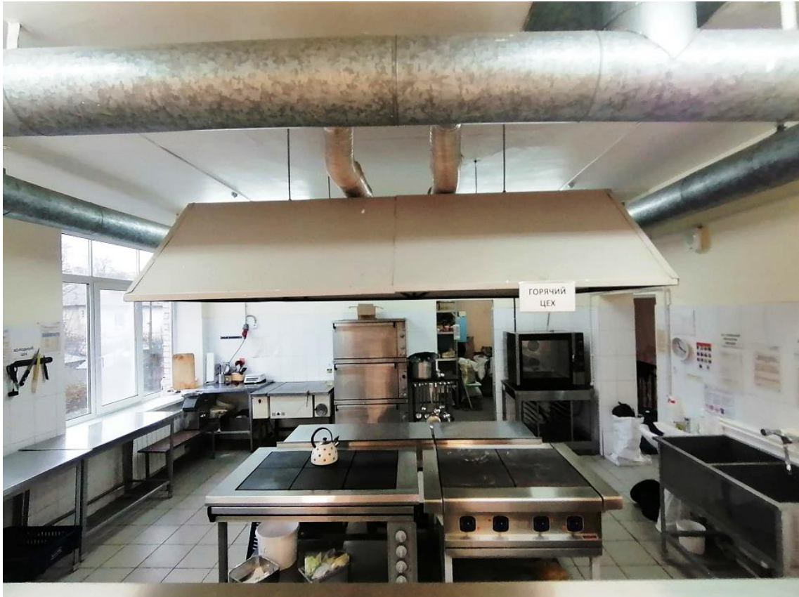
рис. 8. Нерабочая вытяжная вентиляция, горячий цех (п.33, 2-й этаж)
