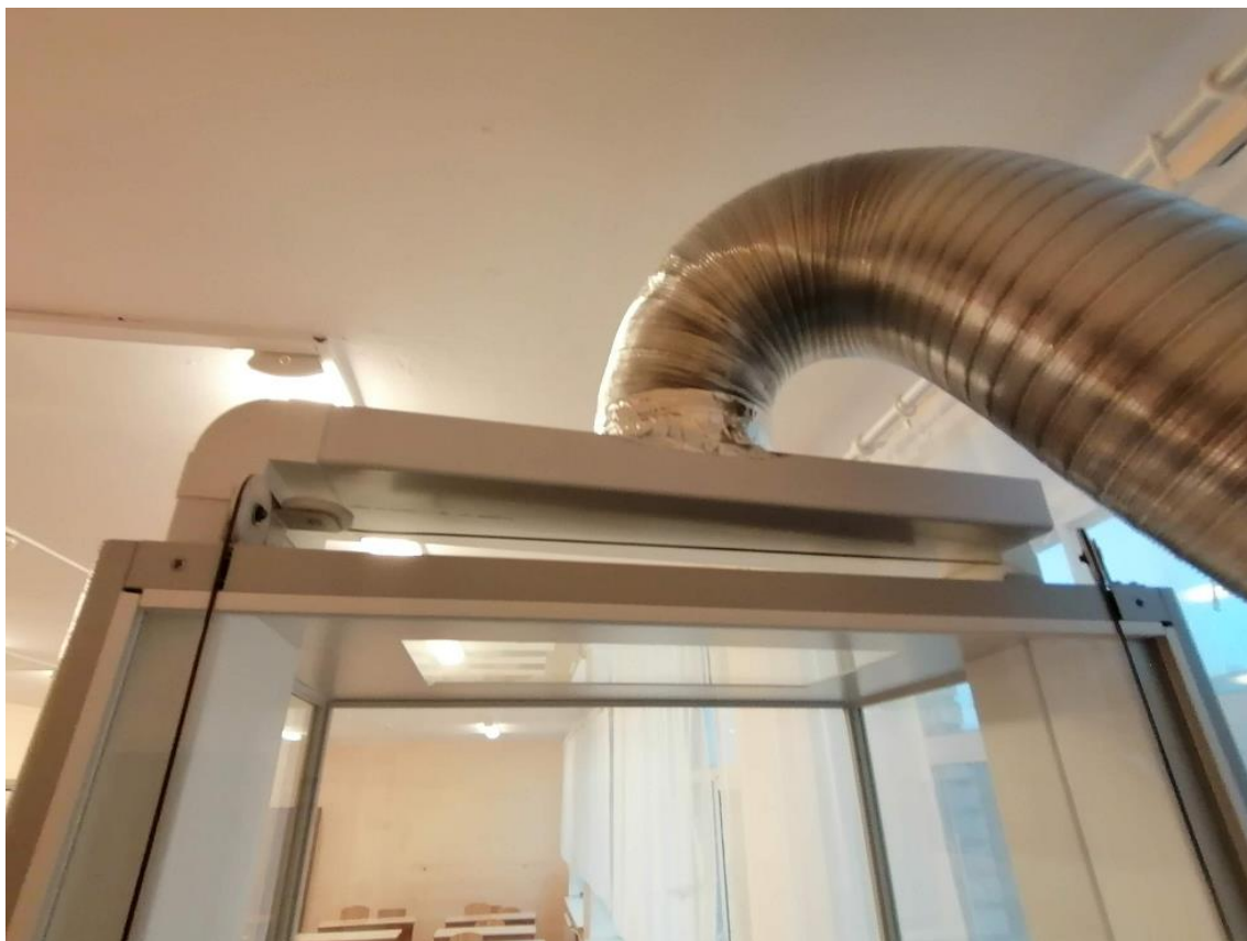
рис. 30. Лабораторный шкаф, система вытяжной вентиляции В2, кабинет химии (п.29, 2-й этаж)
