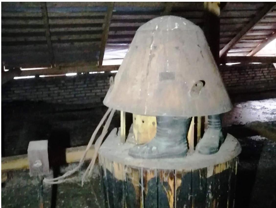
рис. 37. Нерабочий вентилятор, предположительно, относящийся к лабораторному шкафу, лаборантская химии (п.30, 2-й этаж)
