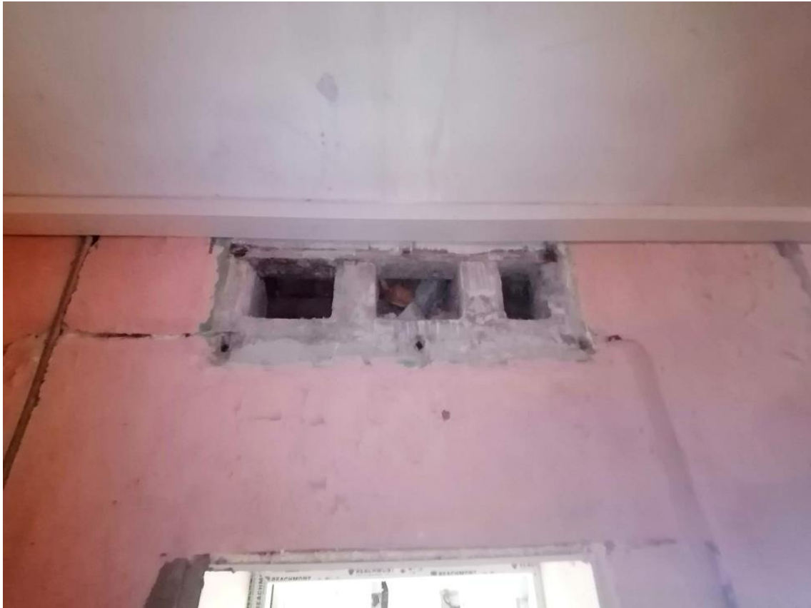
рис. 58. Вентканалы без решеток, кабинет технологии для мальчиков: слесарная мастерская (п.47, 1-й этаж)
