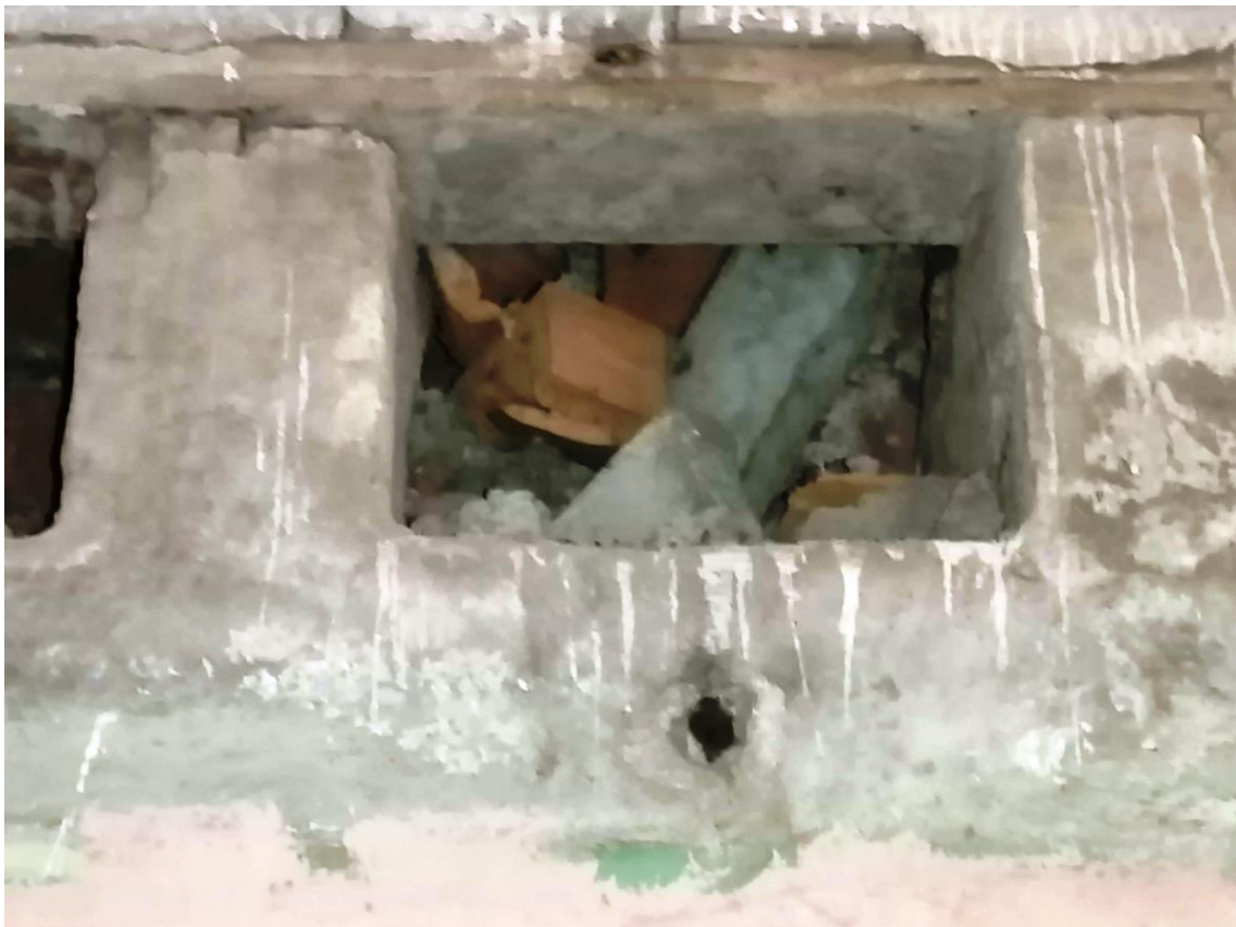
рис. 59. Вентканал без решетки, завал, кабинет технологии для мальчиков: слесарная мастерская (п.47, 1-й этаж)
