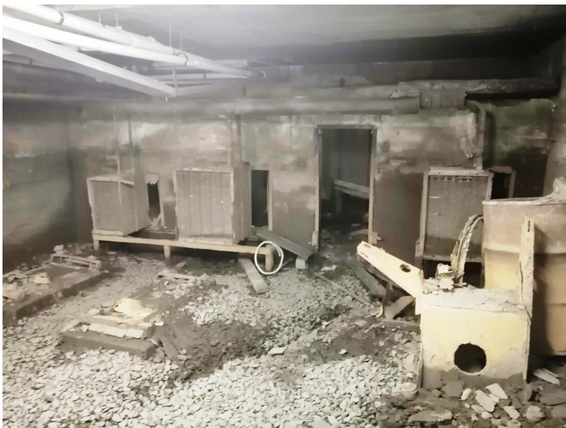
рис. 1. Секции трех воздухонагревателей бывших систем приточной вентиляции, венткамера (подвал)
