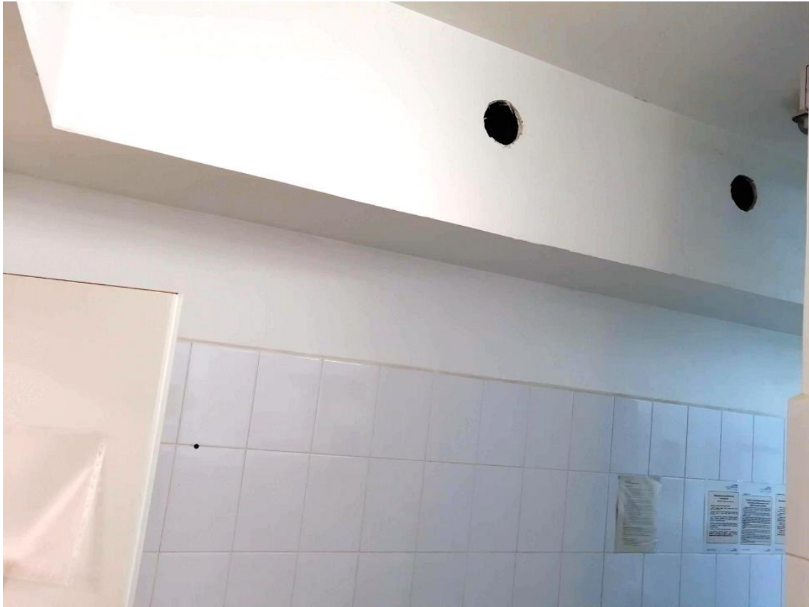
рис. 10. Нерабочая вытяжная вентиляция, моечная (п.38, 2-й этаж)
