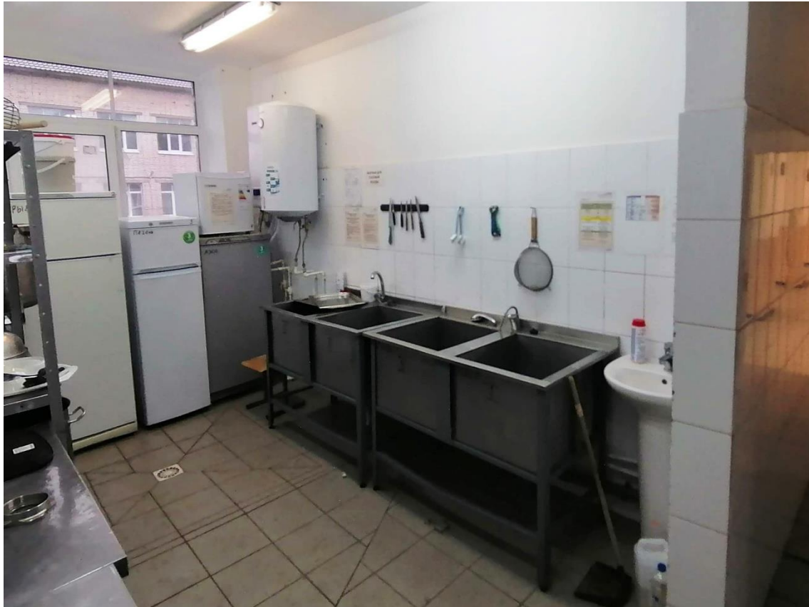
рис. 17. Моечные ванны не оборудованы вытяжными зонтами, мясо-рыбный цех (п.37, 2-й этаж)
